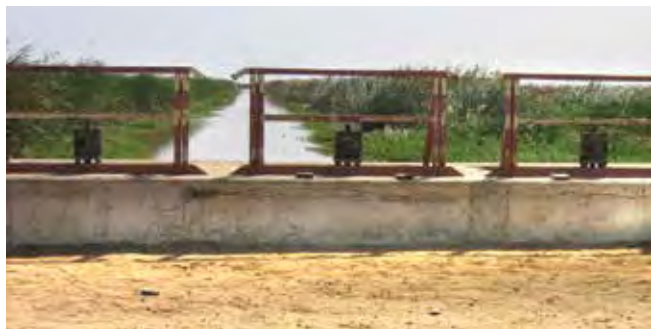
Parc National du Diawling, Mauritanie : L'écluse de Lemer permet l'inondation du bassin du Bell par le fleuve Sénégal. Sa construction fit partie d'un projet visant à restaurer le cycle des crues dans le delta (Étude de cas 6). © Parc National du Diawling, Mauritanie
