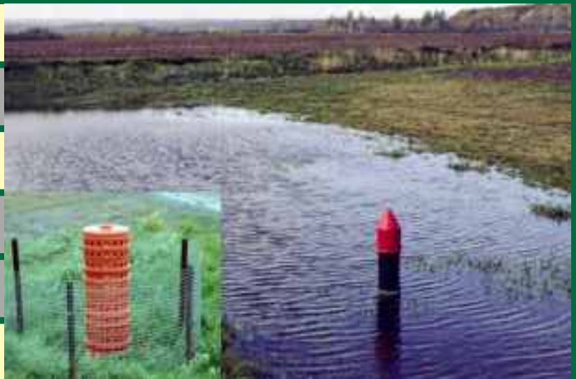
Avaloir et bassin de sédimentation
